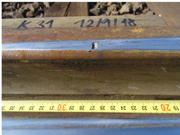
Obrázek 11 - Stav vady 511B před provedeným opravným broušením
