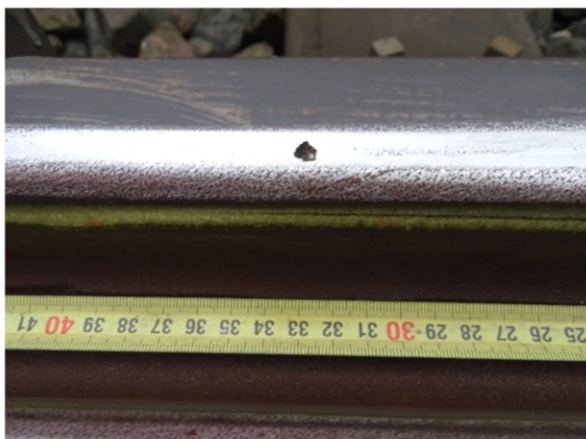
Povrchová vada na křídlové kolejnici
